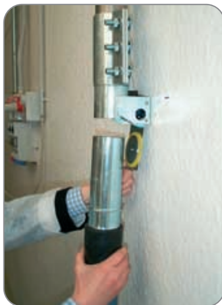
Automazione dell'avviamento dell'impianto
